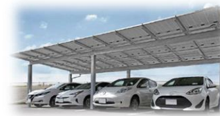
Solar Carport POGERO
